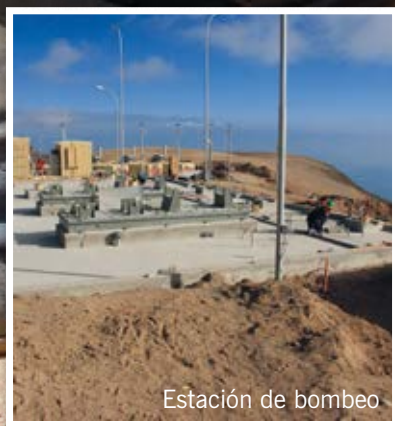
Instalación a 52 bar
