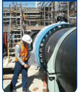
Planta desaladora (Australia), Gran Diámetro
