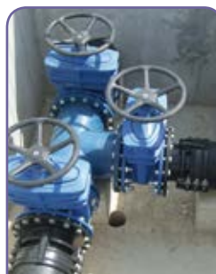
Central Térmica de Martigues, Marsella (Francia), AquaGrip
